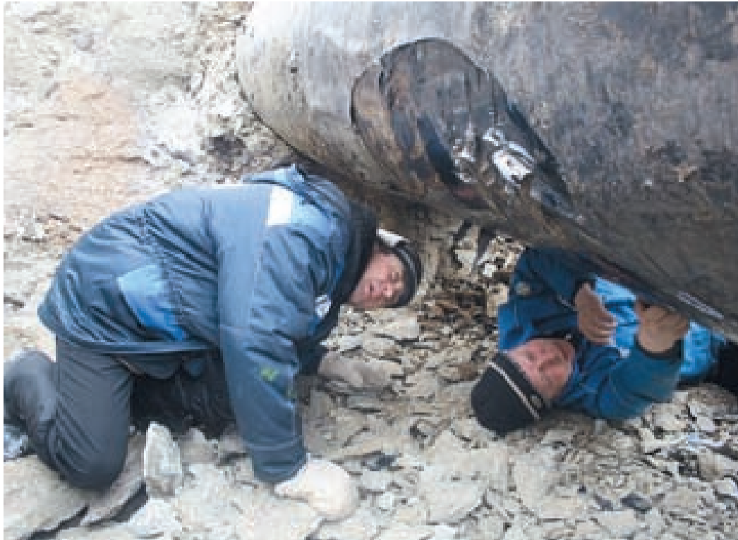
Игорь Хасанов и Александр Мышланов проводят визуальный осмотр трубы на наличие дефектов
